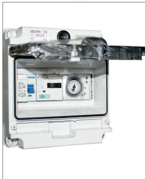
CUADROS ELÉCTRICOS QUADROS ELÉCTRICOS
